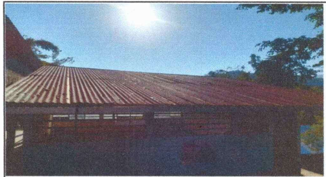
Foto 4: Techo de aula en mal estado
