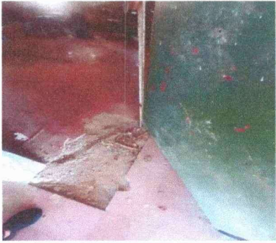
Foto 1: Piso de la entrada en mal estado
