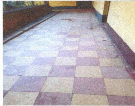
Foto 2: Piso de los corredores en mal estado
